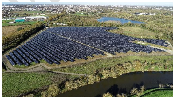
Parc solaire des Ponts-de-Cé – Crédit Photo : ALM
