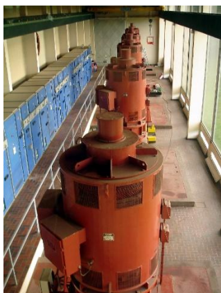
Groupes de pompage de la station
